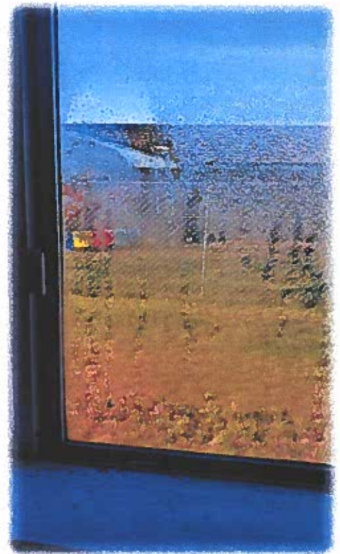
(Porous Moldy Windows)
